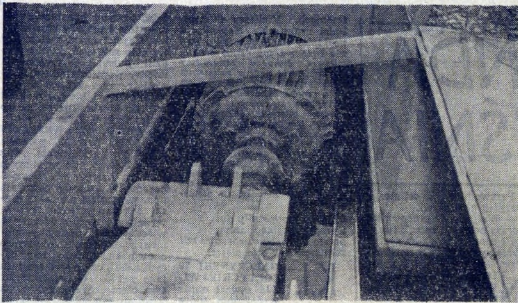
W powiedzeniu, że „pieniądze leżą na ulicy” wiele przesady nie ma. Oto w rejonie Wielkich Pieców mokną w wodzie niepotrzebne tu obecnie silniki, które z powodzeniem mogłyby znaleźć zastosowanie w innych wydziałach produkcyjnych huty. Jak się dowiedzieliśmy, silniki te, należące do Działu Inwestycji, zamontowano przed rokiem w związku z uruchomieniem IV Wielkiego Pieca. Obiecano je usunąć dopiero teraz — na interwencję ludzi, myślących po gospodarsku. I jak tu, w świecie takich faktów, mówić o oszczędności, obniżce kosztów własnych i potrzebie szukania rezerw produkcyjnych? Foto: B. Łuckoś
