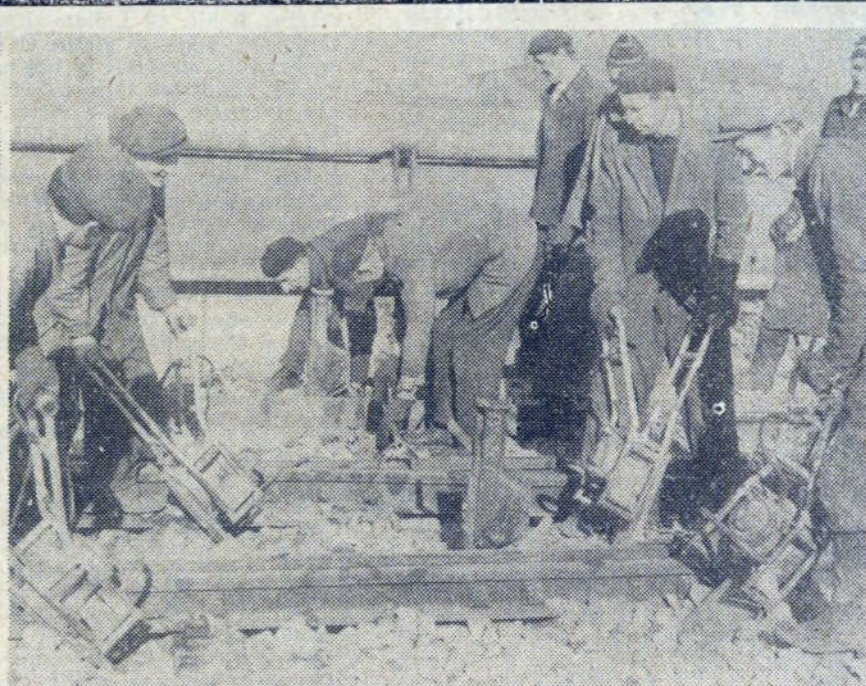
Mechanizacja robót to rowych. Przy pomocy tych urządzeń, podbijanie torów tłuczniem idzie szybciej i nie kosztuje tyle wysiłku. Fot. M. GLADYSEK
