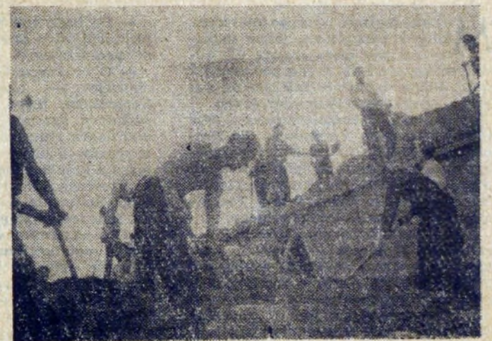
Pracownicy Wydziału Szamotowego ZMO nadal pracują przy budowie basenu i przodują wśród innych Wydziałów HIL.
