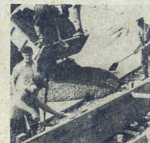
A oto betonowanie schodów amfiteatru. O tempie tych robót świadczy jedna po drugiej zajeżdżająca wywrotka z betonem.
