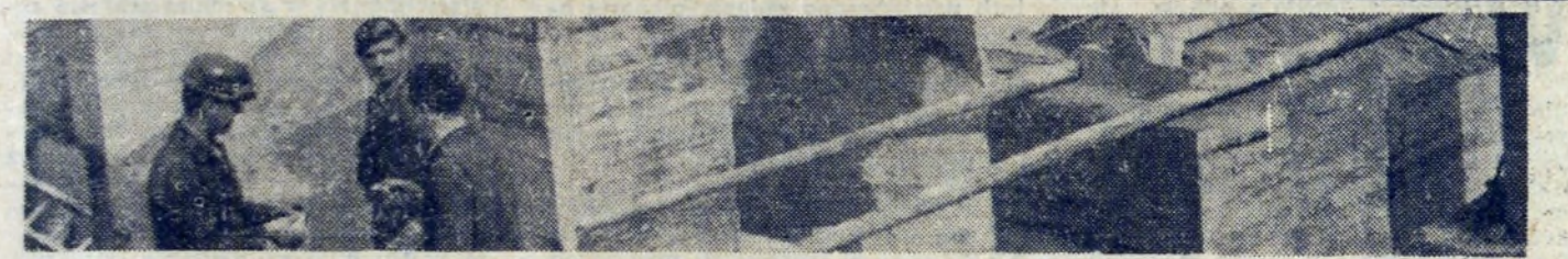
Prace przy budowie w. pieca nr. 5 w pełnym toku. Rano krótka narada.
