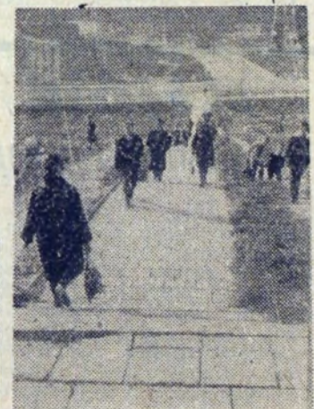
Schody w kierunku szkoły Na Wzgórzach wymagają koniecznego remontu. Są strome, niewygodne, płyty chodnikowe już się zapadają...
