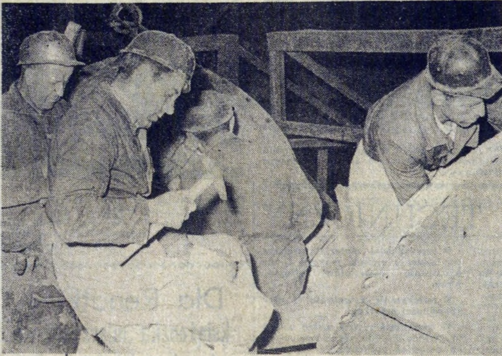
Praca przy generalnym remoncie wp. nr 4 trwa. Toczy się tutaj walka o skrócenie terminu robót. Bierze w niej udział załoga HPR — zarówno ze śląskiej „centrali” jak i z OR w hucie. Przy wymurówce tzw. rękawów pieca wyróżniają się murarze z brygady M-10 HPR-u: Wincenty Rokita, Ryszard Kurpiesz, Władysław i Stanisław Włodarczykowie.
