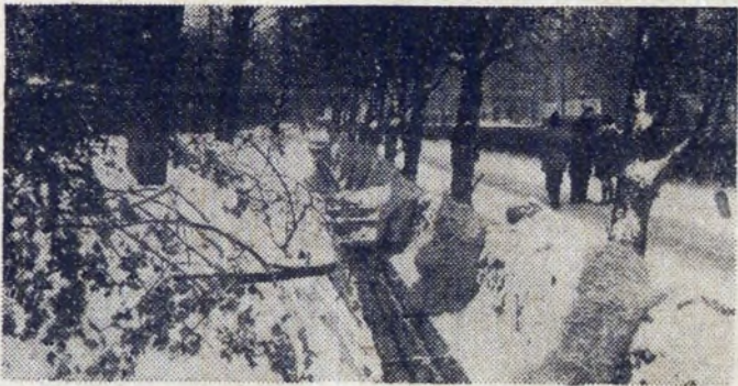
Nie zakończono przed nastaniem zimy wymiany zużytych rurociągów przy drodze nr 1. Z tego powodu odkryto korzenie pięknie rosnących drzew tej najpiękniejszej drogi kombinatu. Dla zapobieżenia ich przemarnięcia zastosowano słomiane maty. Jak będą się drzewa budzić z zimowego snu na wiosnę, mając jedynie połowę korzeni — zobaczymy. Niewątpliwie trzeba będzie obciąć w maksymalnym stopniu gałęzie, chociażby z tego powodu, by drzewa zachowały równowagę.
