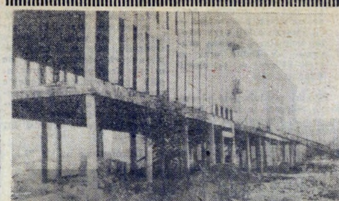
Na budowie szkoły muzycznej w Nowej Hucie — os. Na Skarpie. Rośnie betonowy szkielet obiektu. Fot. E. Synowiec
