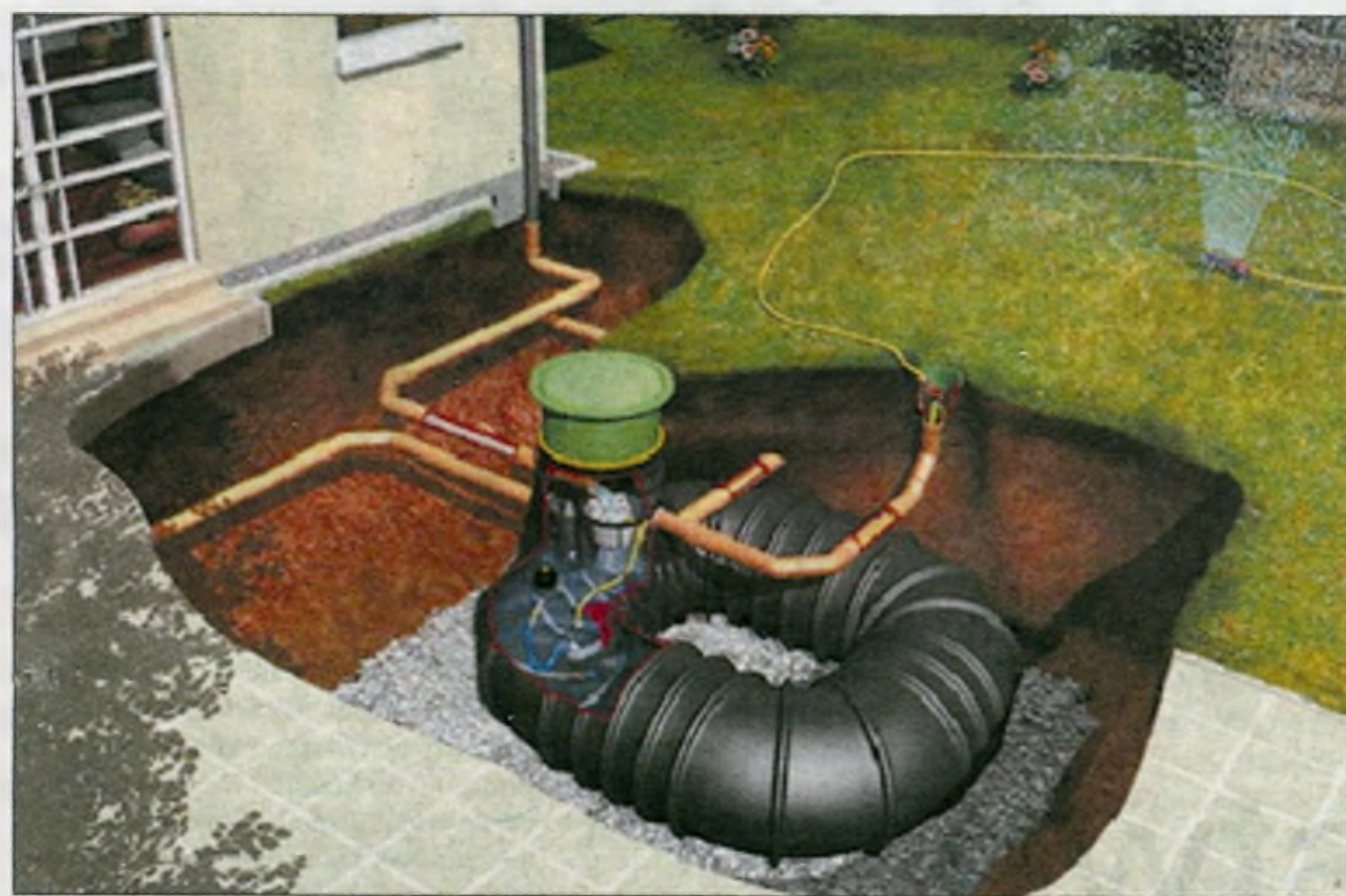
Woda deszczowa może być gromadzona zarówno w zbiornikach podziemnych...
