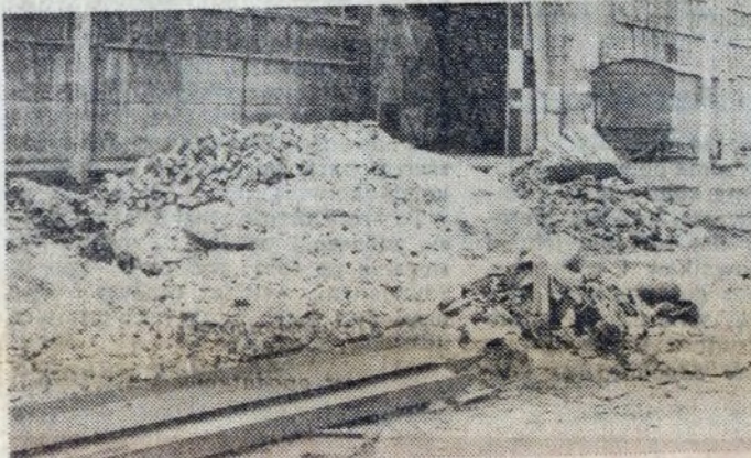
W rejonie wykańczalni, obok P-64 również straszy bałagan. Zwaly gruzu, cegieł, żelastwa — jak długo jeszcze panować będzie taki stan?!
