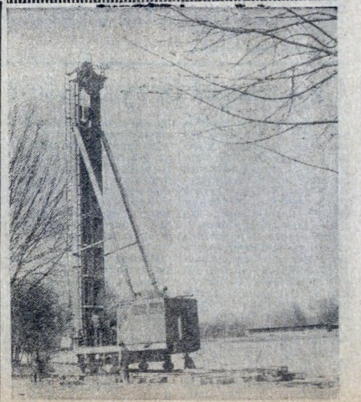
Nad nowohuckim Zalewem przy ul. Bulwarowej stanie już niedługo Dom Wędkarza. W tych dniach zakończono prace przy palowaniu. Te trudne roboty, ze względu na niemożność uzyskania odpowiedniego sprzętu oraz z uwagi na napięte terminy — mogły być wykonane dzięki ewidentnej pomocy członków dyrekcji „Budostalu” oraz kierownika Hydrobudowy nr 3. Za okazaną pomoc komitet budowy Domu Wędkarza składa w imieniu rzeszy wędkarzy nowohuckich serdeczne podziękowanie. Na zdjęciu — palowanie obiektu. Fot. M. GLADYSEK
