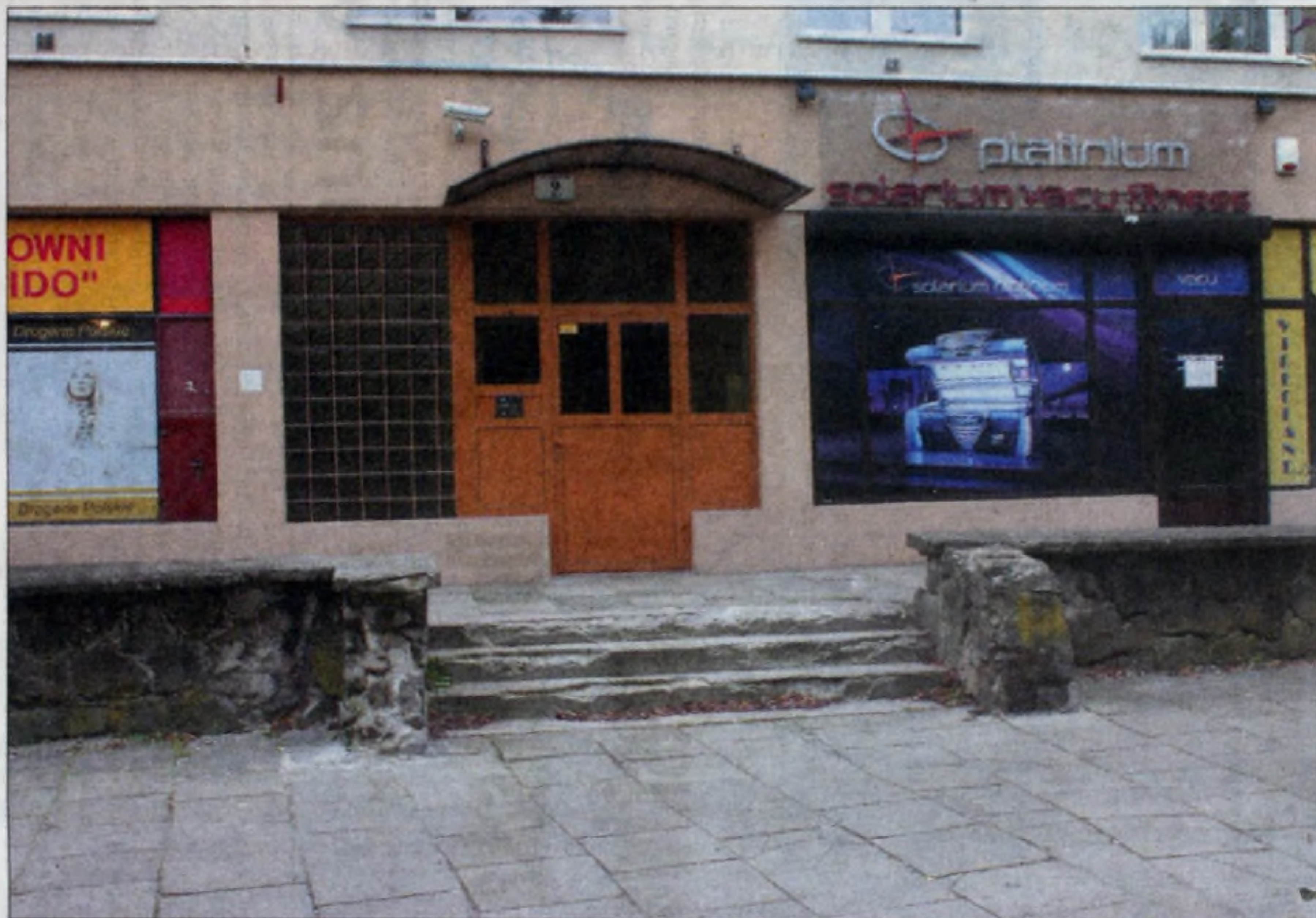
Rozsypujący się murek przed blokiem nr 9 os. Słoneczne, który stanowi element skweru przed budynkiem.
