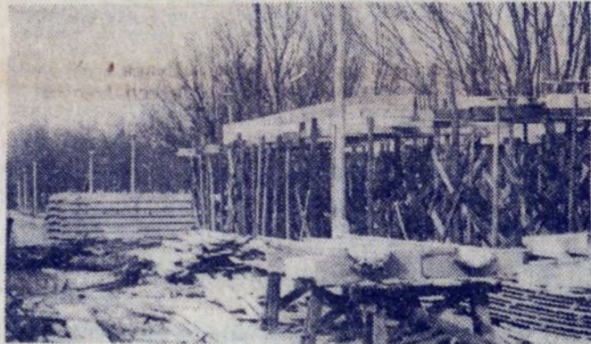
Dom w Zalewie na terenie Zalewu. Fundamenty, szalunki, a na budowie nikogo nie widać. Na co wiaściwie czekamy?
