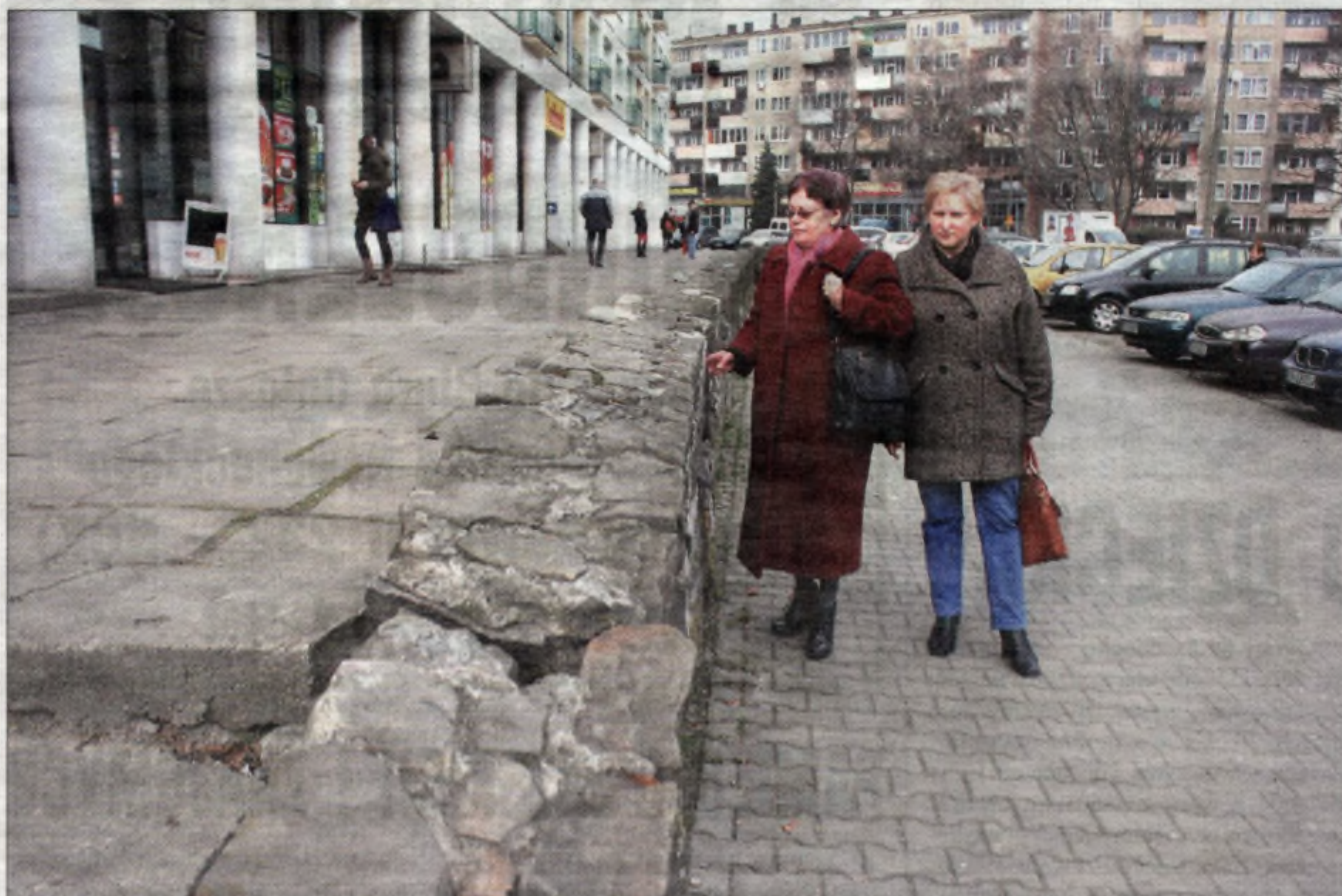
Przechylający się i niszczący murek przy pizzerii i sklepie Kefirek na osiedlu Centrum B.
