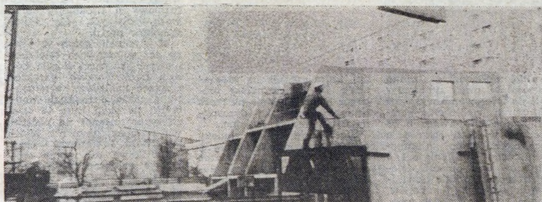
Na zdjęciu po lewej — dzisiejszy stan budowy bloku w os. Piasta Kołodzieja. Po prawej — wyłaniające się zarysy osiedla domków jednorodzinnych w Mistrzejowicach-Wschód. Nie mniejszy niż na pozostałych placach budów postęp robót dostrzegli goście i organizatorzy przedsięwzięcia w os. Kazimierzowskim. FOT. STANISŁAW GAWLIŃSKI
