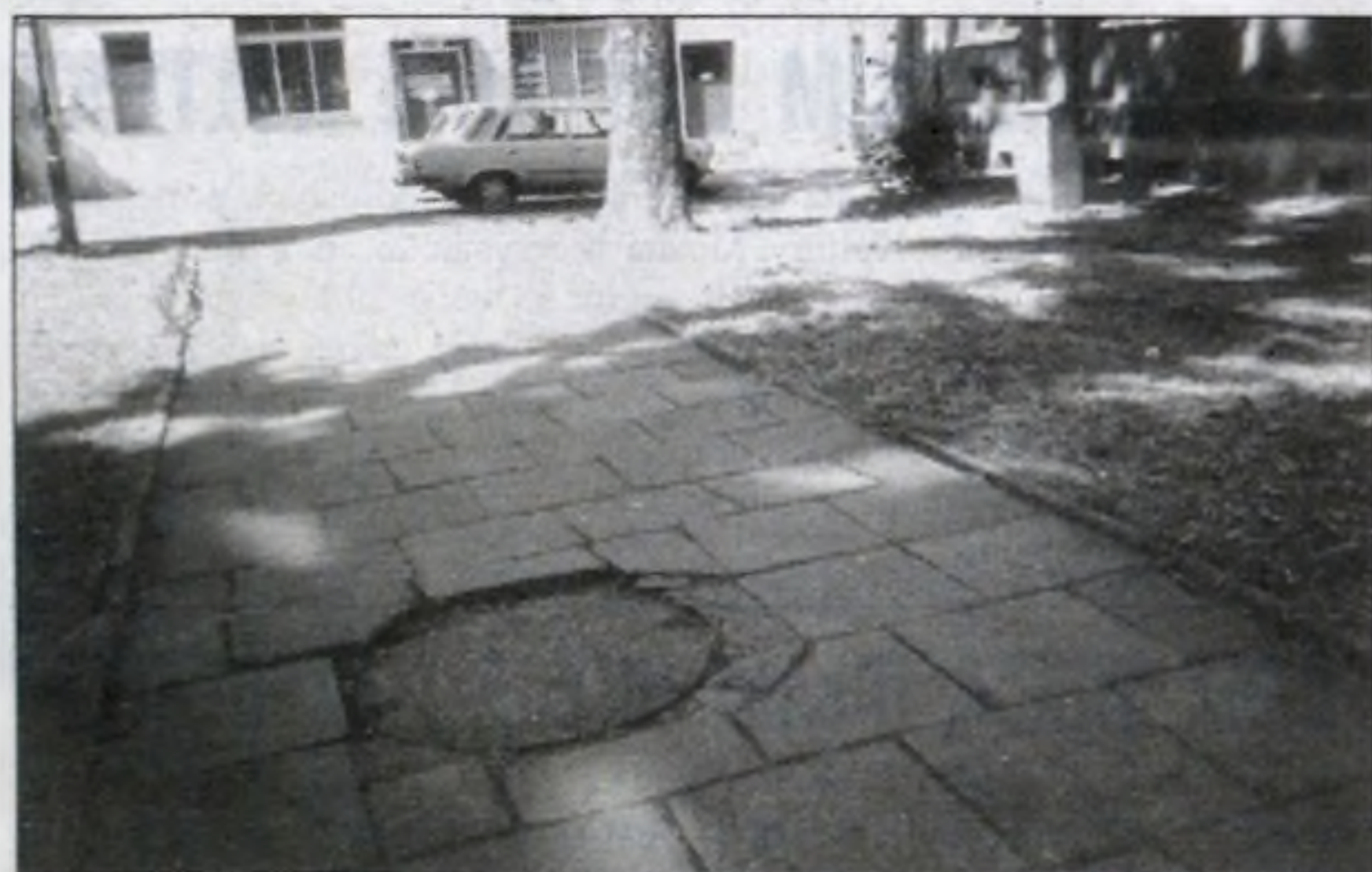
Jak będzie wyglądał ten chodnik po ulewie? Zdjęcie zrobiono w pobliżu budynku MOPS nr 4 w os. Szkolnym.
