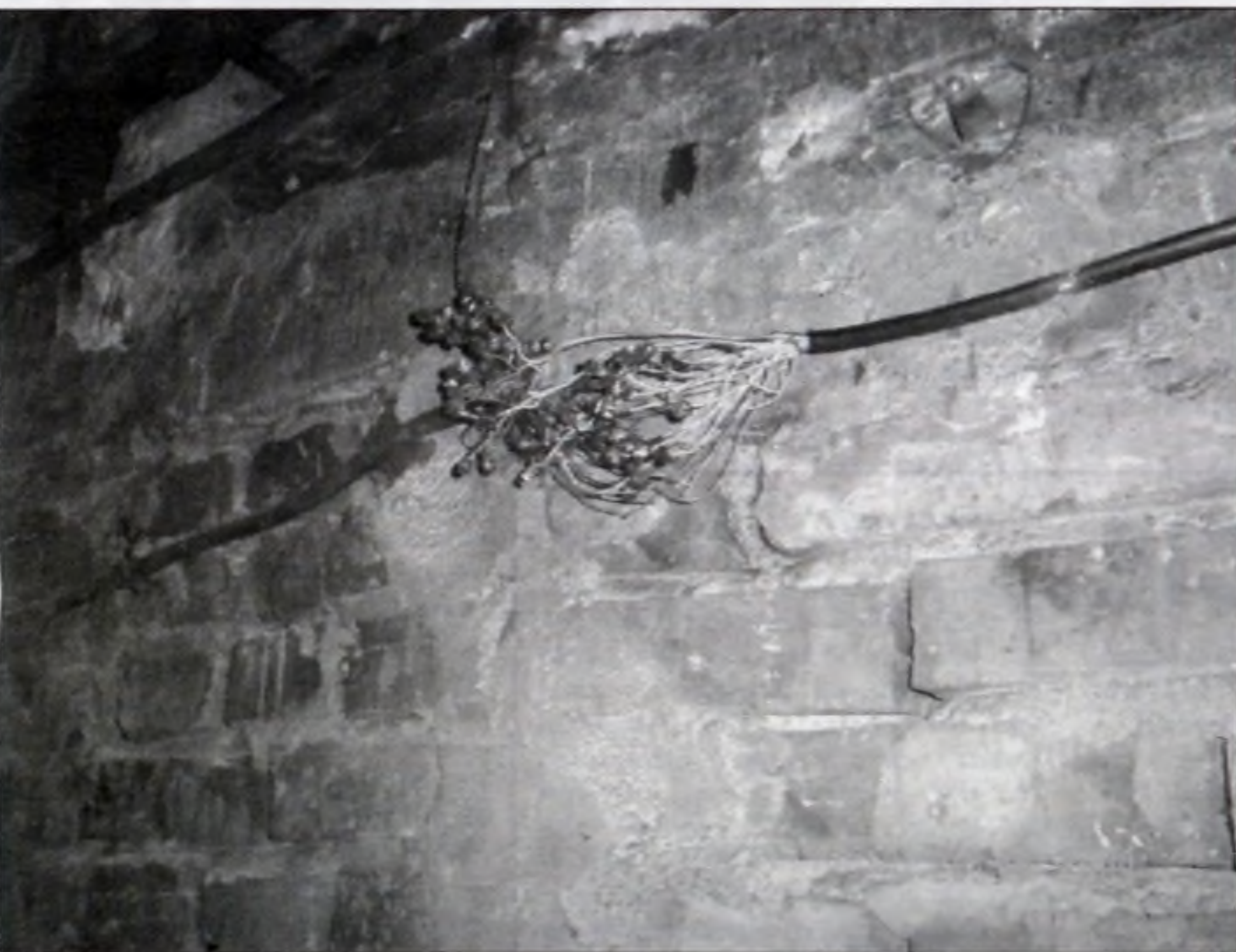
Wiązka kabli telefonicznych przygotowana do kradzieży impulsów.
