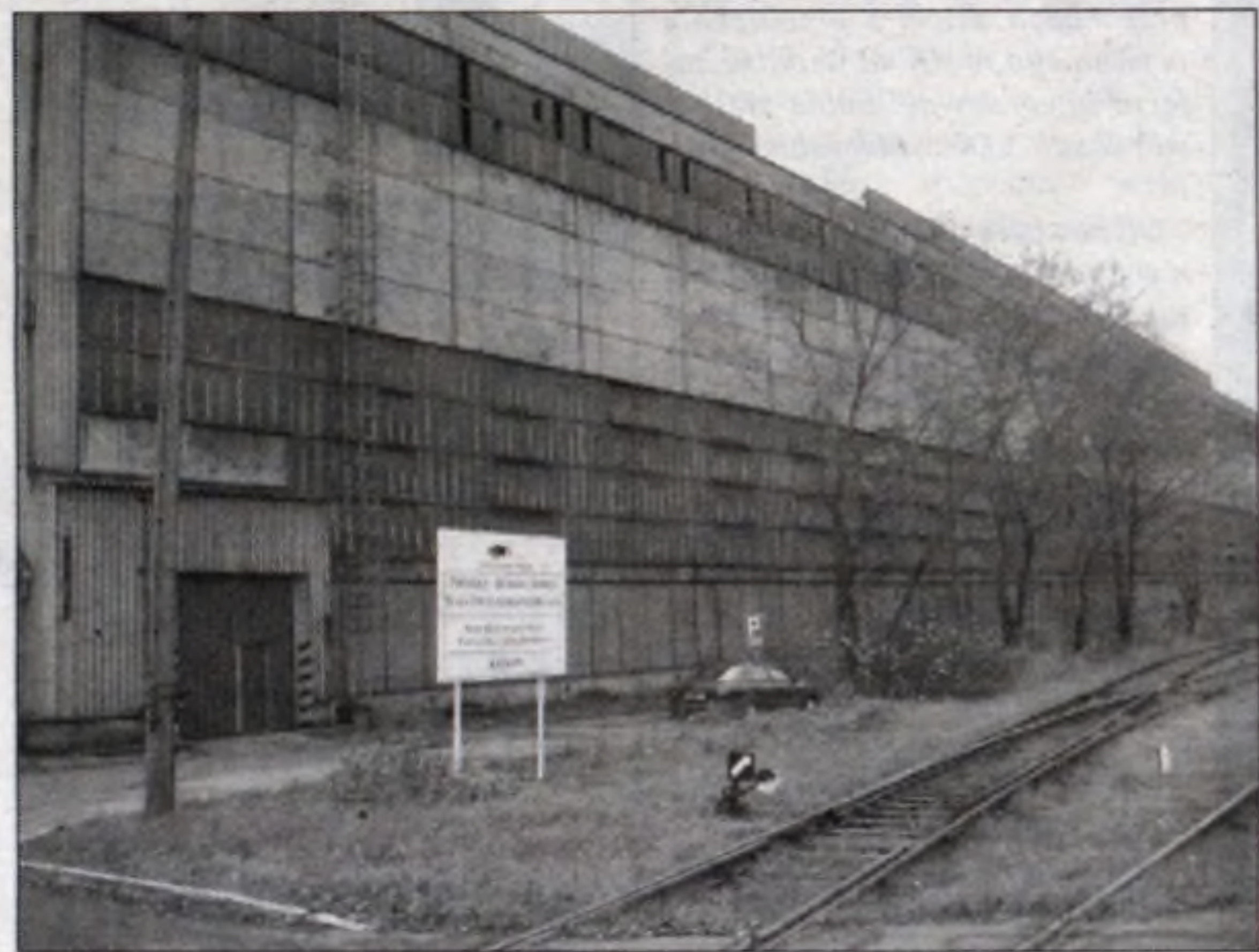
Hala pozostanie, ale w miejsce starych urządzeń walcowni slabing zostaną zamontowane nowe – walcowni gorącej blach...
