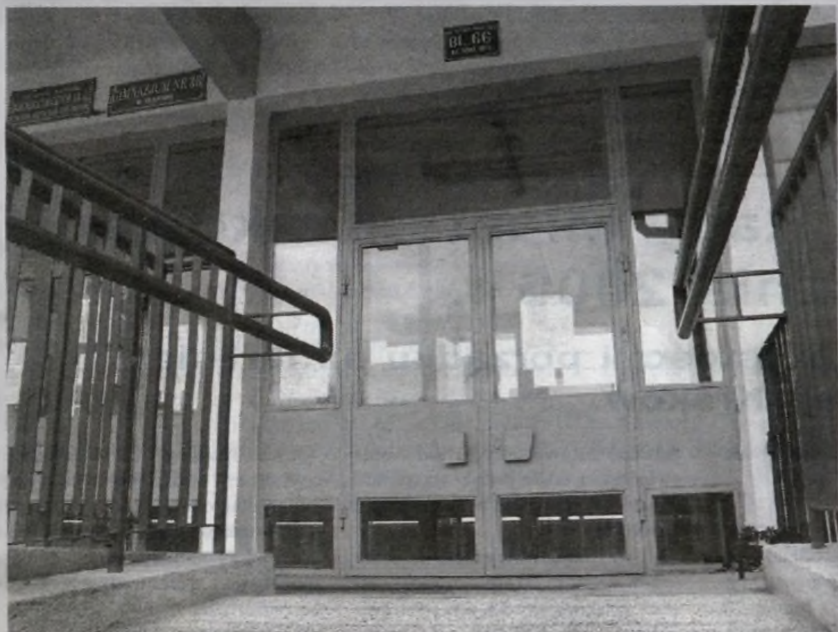
Podjazd prowadzi pod ciężkie, stalowe drzwi, z otwieraniem których nie radzą sobie osoby na wózkach. (fot. Jerzy Woźniakiewicz)
