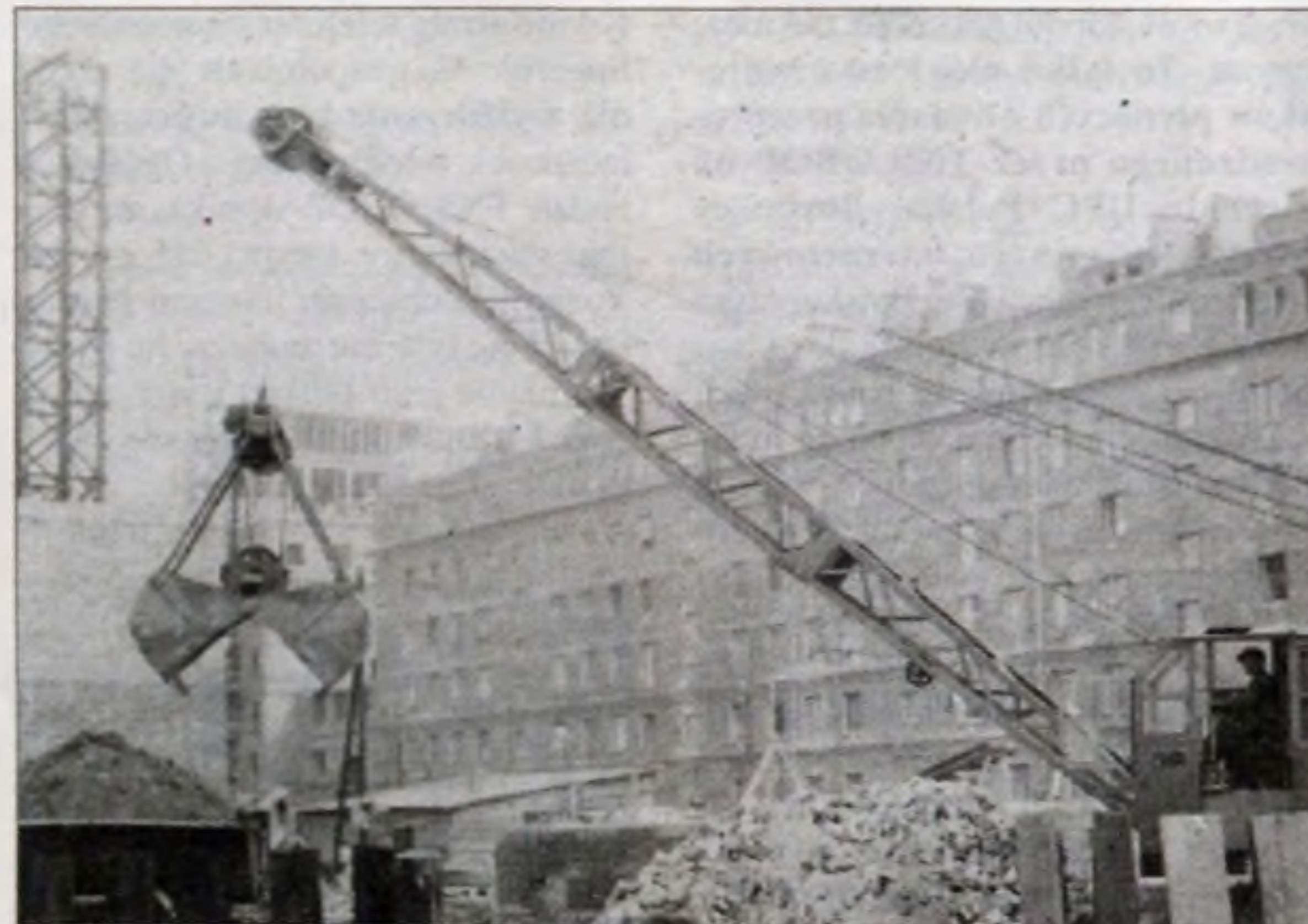
Budowa domu mieszkalnego przy placu Centralnym, ok. 1954 r. Fot. Wojciech Łoziński, ze zbiorów MHK.
