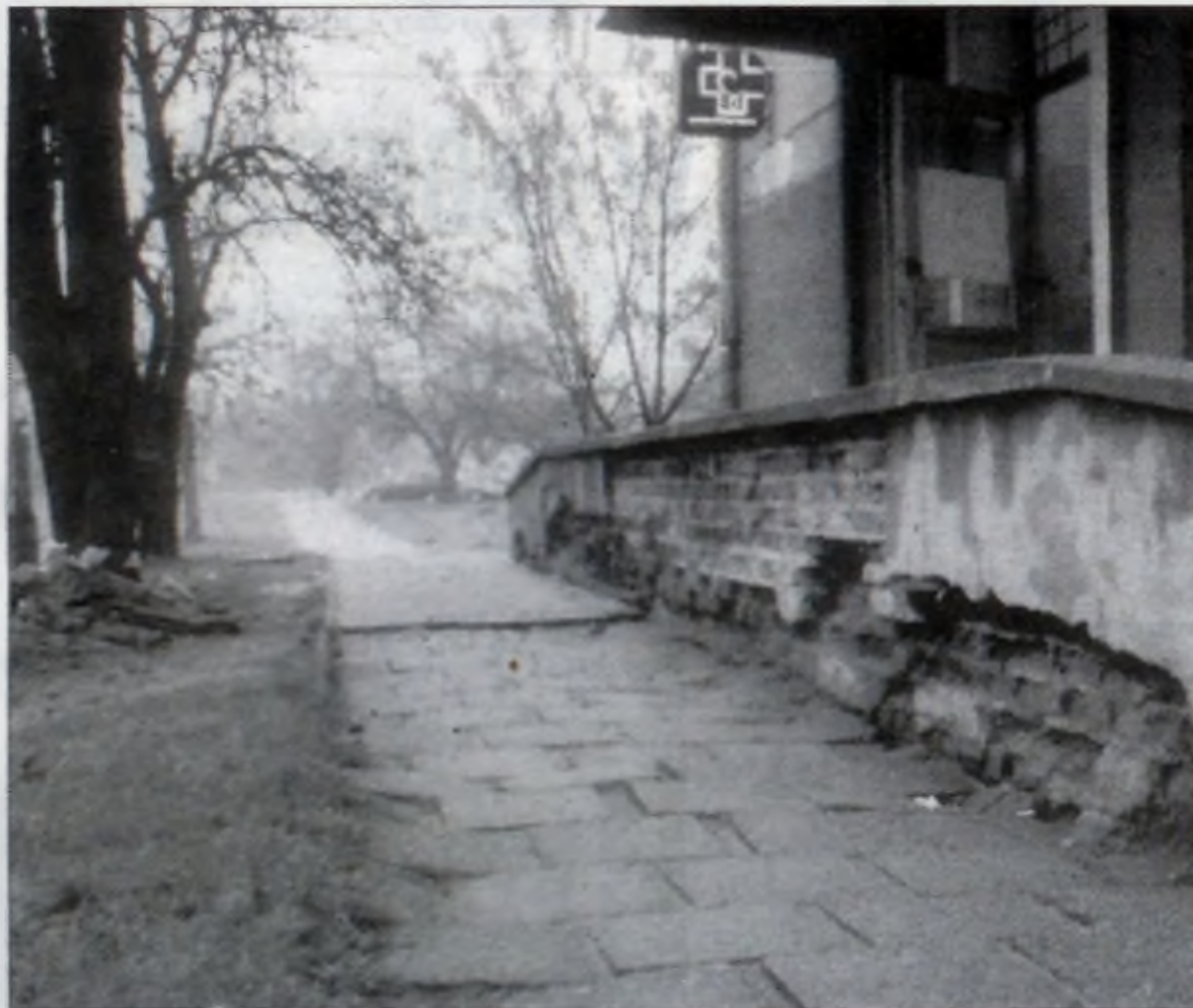
Zniszczony chodnik przy wejściu do przychodni.
