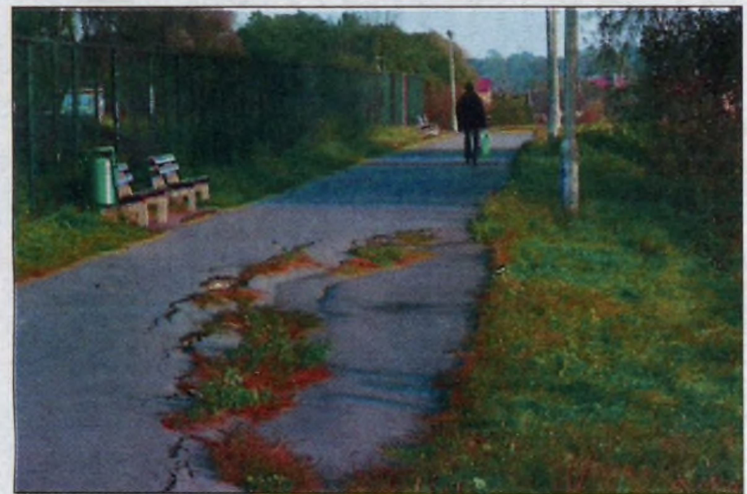
Pęknięcia alejki w okolicach Szpitala im. Żeromskiego.
