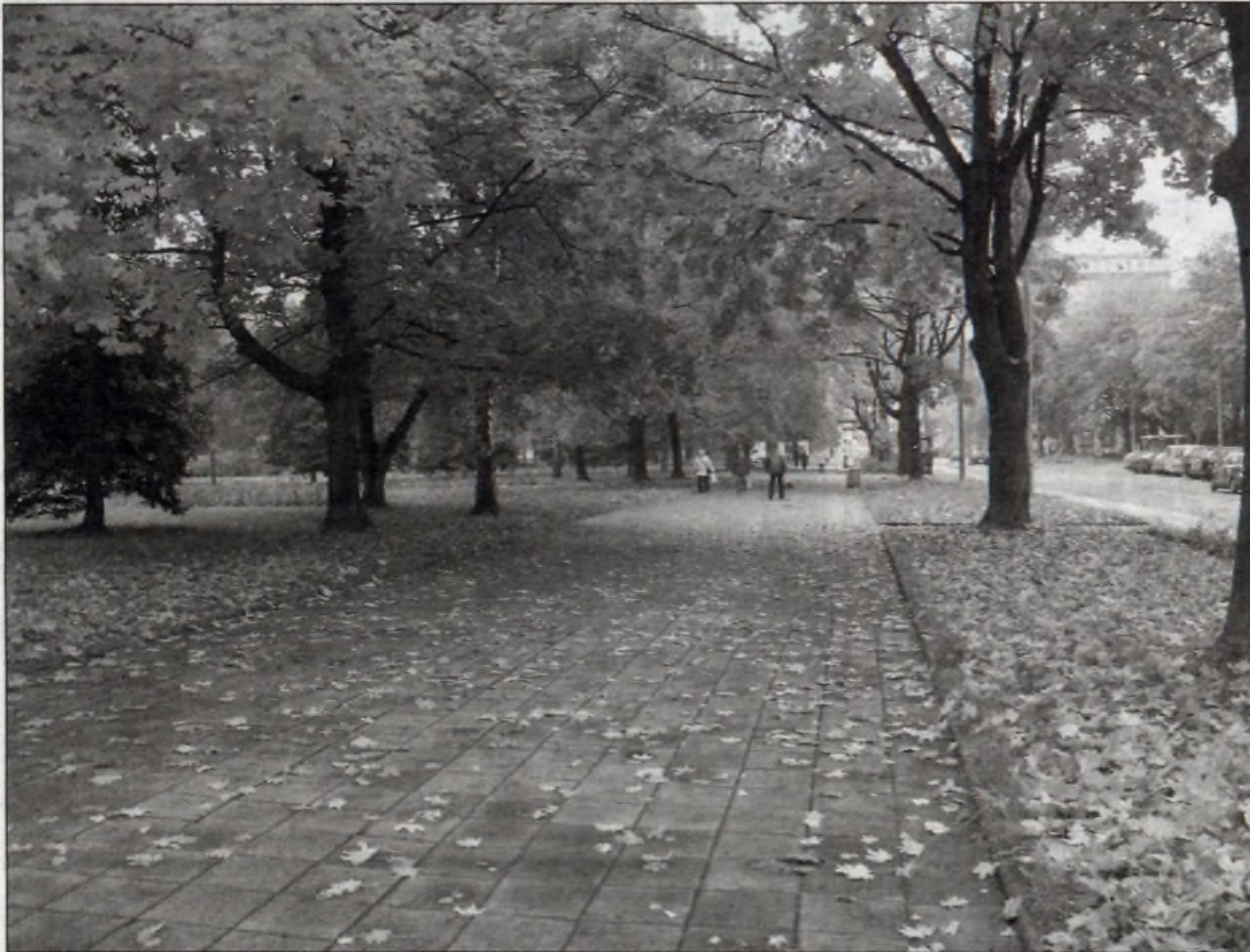
Chodnik w al. Róż od strony parku Ratuszowego kwalifikuje się do generalnego remontu.
