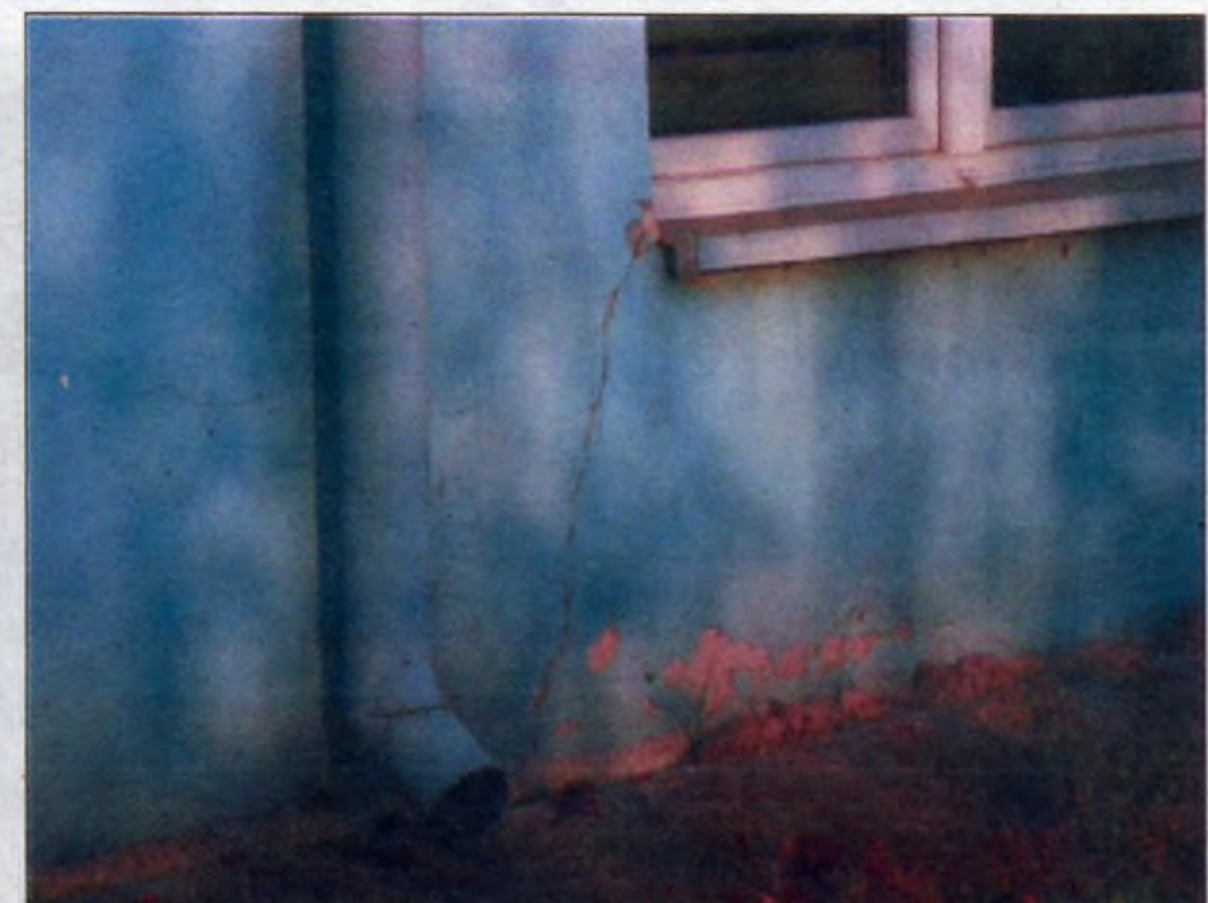
Pęknięcie widoczne na ścianie bloku nr 5 w os. Centrum E.
